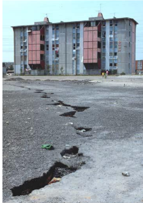
Fig 6 Grieta en un lago recreativo de un conjunto habitacional (Ixtacalco) Anomalías
