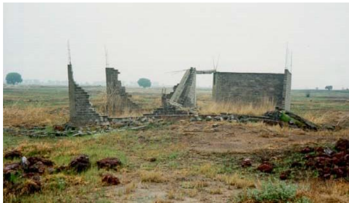
Fig 9 Hundimiento no uniforme en zona de transición (periferia del cerro Huatepec, Texcoco)
