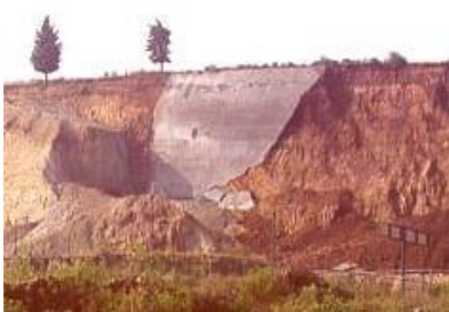
Fig 19 Falla de un revestimiento a base de anclas y concreto lanzado
